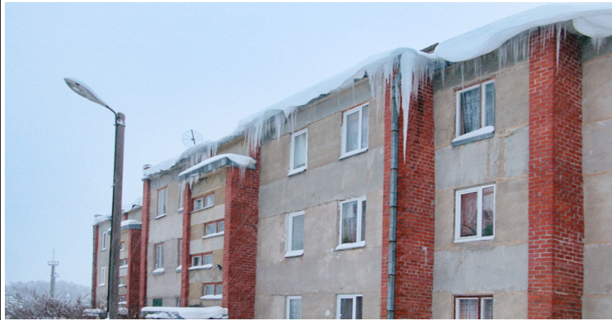
Lāstekas uz jumta liecina par sliktu jumta siltuma noturību.
